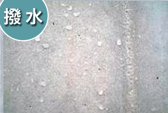
コンクリート表面から撥水された水滴
